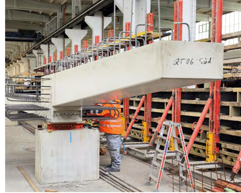
FERTIGGESTELLTER QUERTRÄGER IM FERTIGTEIL-WERK Höchste Qualität und Präzision trotz komplexer Querträger-Geometrie infolge der spezifischen Anforderungen an den Gleistrog.
