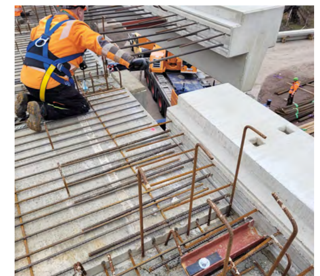
MONTAGE FERTIGTEIL-KAPPEN Die Kappenelemente wurden ebenfalls seriell im Werk vorgefertigt. Die Montage der 62 Fertigteil-Kappen erfolgte innerhalb von 6 Arbeitstagen (ca. 10 Fertigteile pro Arbeitstag).
