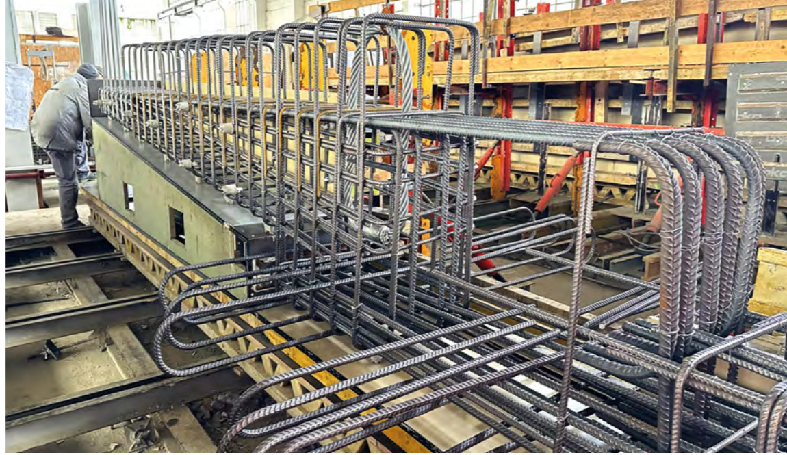
HERSTELLUNG FERTIGTEILE: BEWEHRUNG UNTER GLEICH- BLEIBENDEN BEDINGUNGEN IM WERK Konstruktive Litzenvorspannung im Spannbett.
