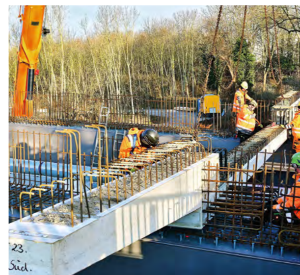
MONTAGE FERTIGTEIL-QUERTRÄGER Die 62 Querträger (16,52 m x 0,30 m [0,90 m] x 0,60 m) mit einem Einzelgewicht von ca. 11 Tonnen wurden innerhalb von 11 Arbeitstagen verlegt. Nahezu zeitgleich wurden parallel 61 Fertigteil-Fahrbahnplatten (C50/60; 2,40 m x 7,00 m x 0,20 m / Gewicht je Element: 7 t) verlegt. Die Höhenjustierung der Querträger gemäß Messprogramm erfolgte ebenfalls innerhalb dieser Arbeitsschritte.
